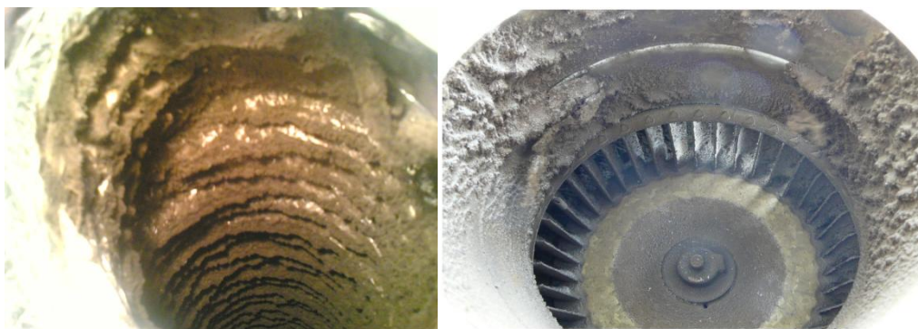
Přepálený prach a nečistoty v rozvodech teplého vzduchu
